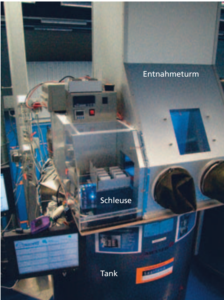
Abbildung 4: Multiplexersystem als Datensynchronisationsstation im Schließensystem des Entnahmeturms auf einem Kryotank. Die blaue LED zeigt den aktiven Kanal für die Kommunikation mit den Datenträgern in der elektronischen Schublade an.
