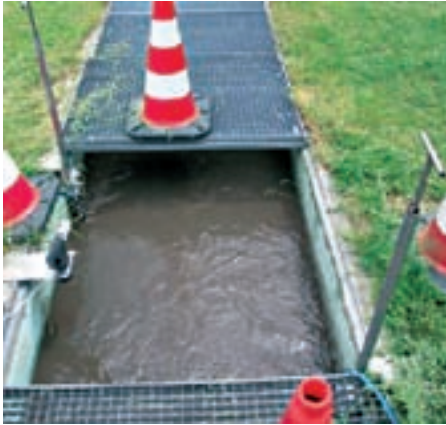
Abbildung 2: An dieser Stelle im offenen Gerinne sind die Ultraschallsensoren an den Seitenwänden des Gerinnes diagonal gegenüberliegend installiert.
